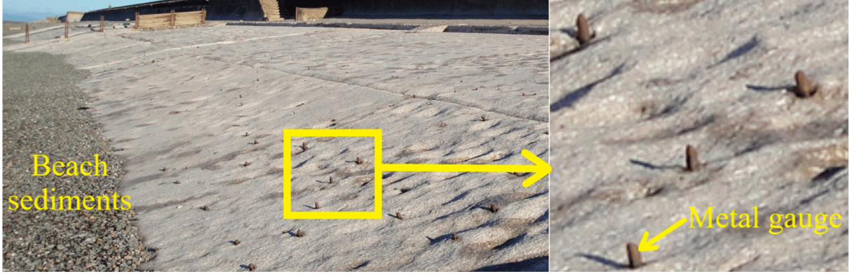
Şekil 1: Betonun kıyı bölgelerindeki aşınma örneği (Kaynak: Omoding, N., vd. "Field Investigation into Abrasion of Concrete at a Coastal Stepped Revetment: A U.K. Case Study, Figure 1" Journal of Marine Science and Engineering, cilt 11, no. 6, 1145, 2023. Erişim: https://www.mdpi.com/2077-1312/11/6/1145 . [Erişildi: 7 Haziran 2025].)
